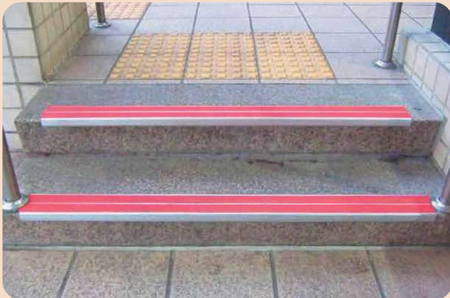
圖 302.2( 補充 2_ 地板表面 ) 樓梯材質防滑 資料來源：王武烈建築師 拍攝地點：台北捷運站
